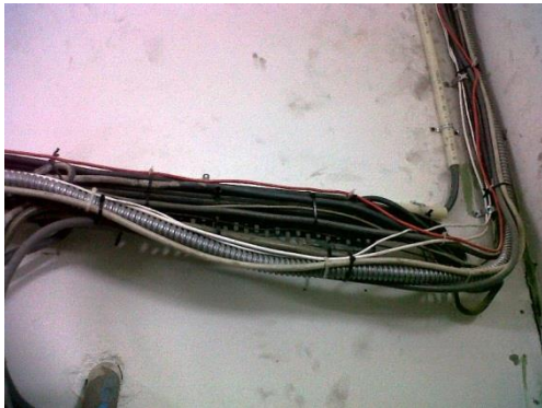
Figuur 46: Kabels met gevoelige en storende signalen aan dezelfde kabelbaan zij aan zij bevestigd
